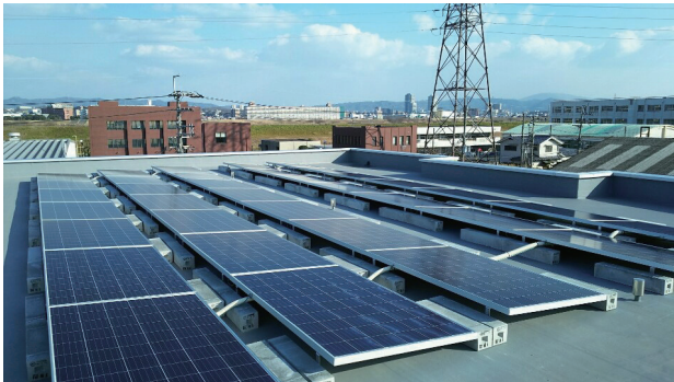
わかさ福祉会グループホームの太陽光発電所
