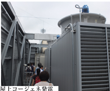
写真3 屋上コージェネ発電
