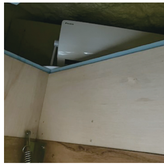
屋根裏のエアコン
